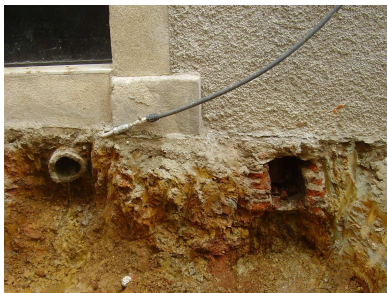
Foto 5. Acometida vieja y mas vieja de una misma vivienda unifamiliar
