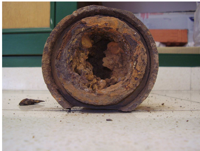
Foto 6. Interior de una tubería vieja de fundición gris
