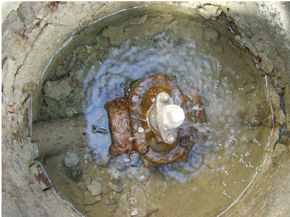
Foto 7. Pérdidas en una válvula de distribución
